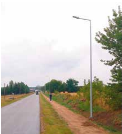
Oświetlenie przy drodze powiatowej
